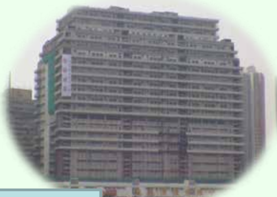
緊急屋宇結構鞏固
