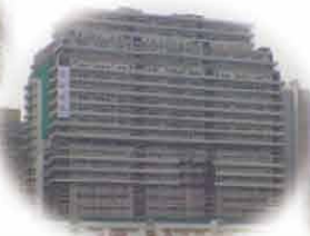
緊急屋宇結構鞏固
